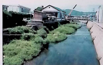
水路の半分は汚泥が積もり「中島」
