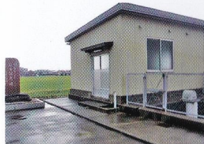
送水ポンプ場
